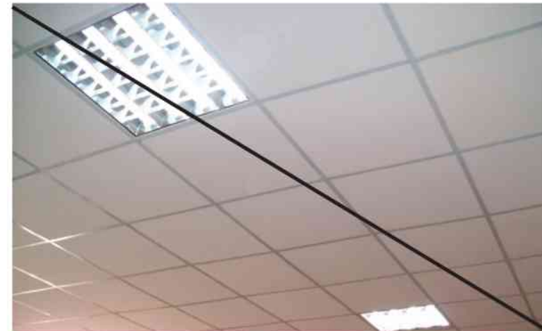
Плохо Открытые направляющие
